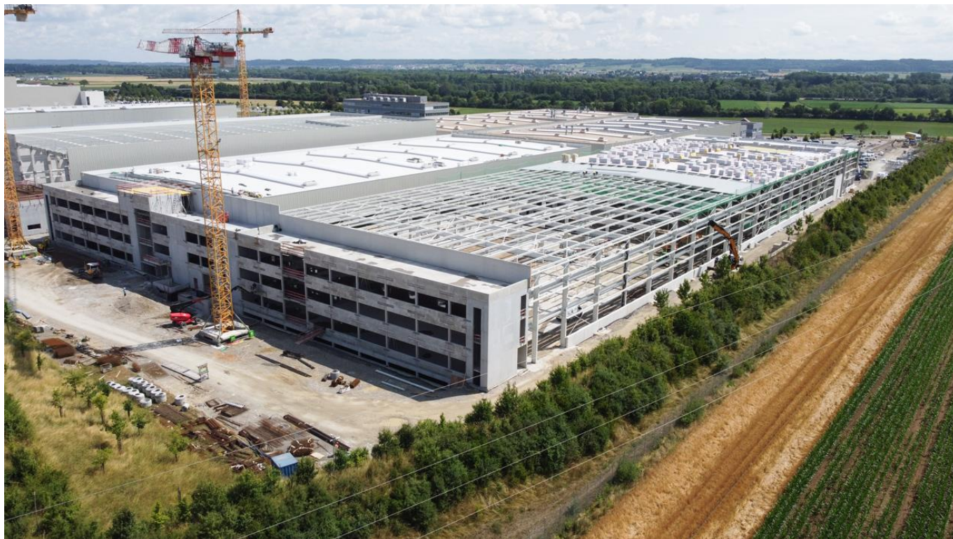
Abbildung 9: Umsetzungsstand des Neubaus im Sommer 2023: Auf 46.000 qm entstehen drei neue Hallen für mechanische Fertigung, Logistik und weitere Bereiche sowie ein zusätzliches Verwaltungsgebäude. Im Hintergrund sind die beiden bereits seit 2017 genutzten Gebäude für Montage, Logistik, Lackierung und Verwaltung zu sehen.
